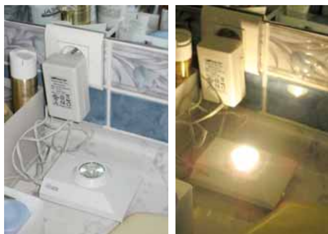
Flash d'alarme dans la salle de bains.
